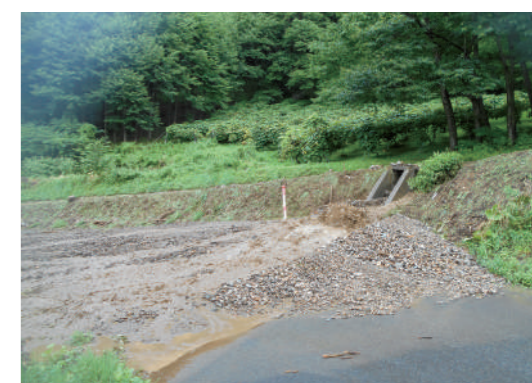
局地的豪雨による土砂の流出 (4年8月：小田地区)
