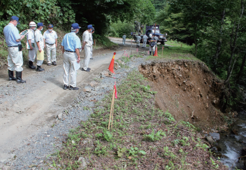
大きく崩れた町道根地戸線
