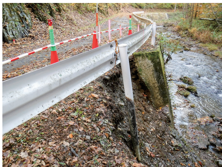
台風19号の大雨により被災した町道(下外川地区)
