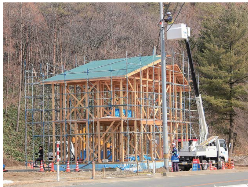
さらなる子育て世帯の受け入れ環境を整備している3棟目の小屋瀬いらっしやい住宅。
