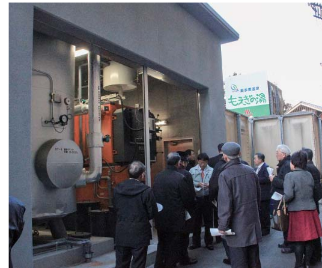
奥多摩温泉「もえぎの湯」木質バイオマスボイラー
