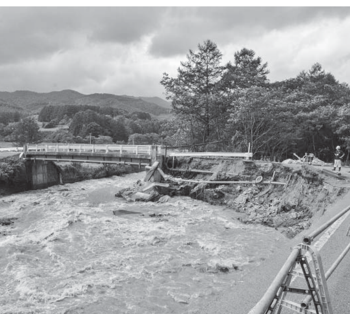
河川の増水によって崩落した国道340号と町道本木遠矢場線（江刈本木地区）
