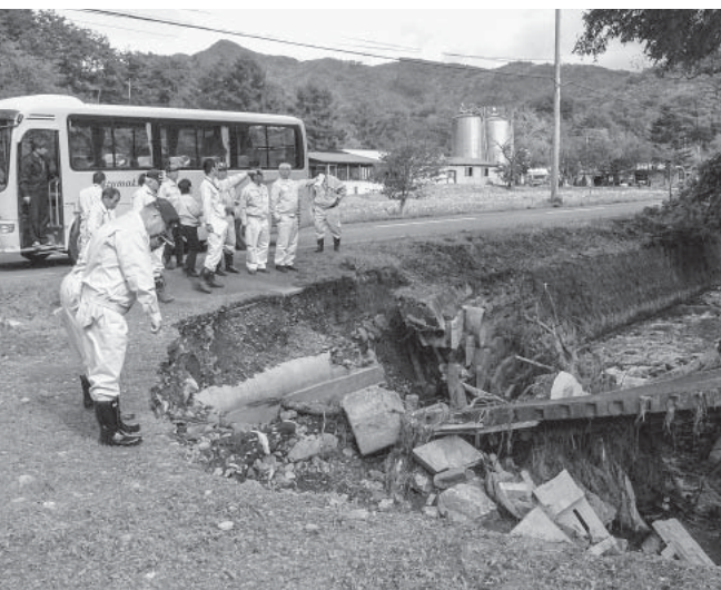
台風10号による被害箇所を確認する議員(星野川)
