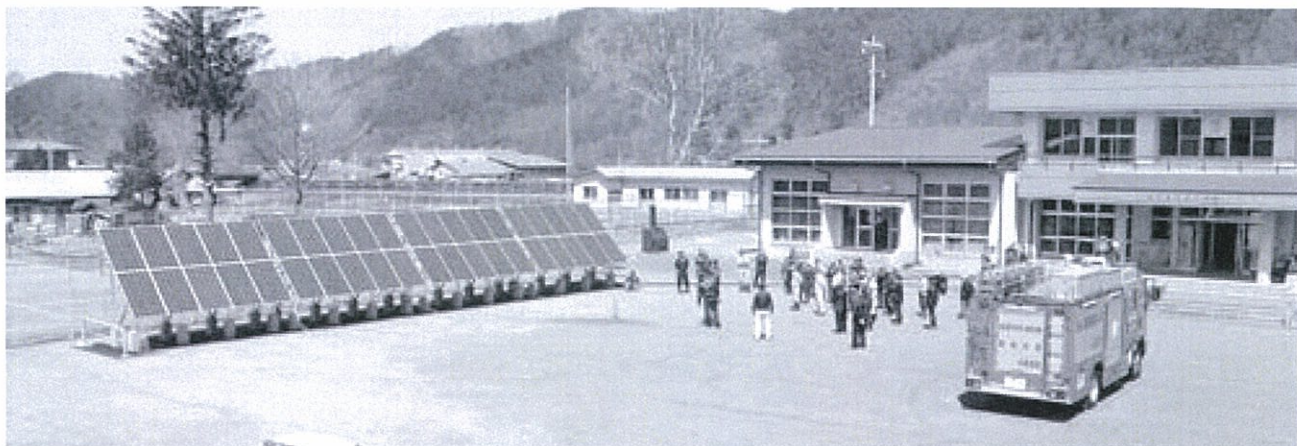
町内25カ所の地区センターに整備された太陽光発電設備（江刈農村センター）
