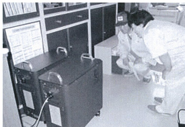
発電した電気は蓄電池に充電し、災害時等に活用
