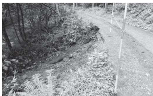
台風18号の大雨で路肩が崩壊した町道上外川線
