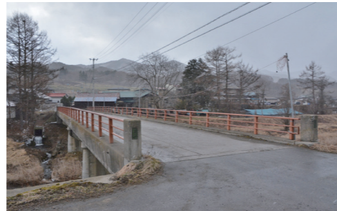
▲昭和44年に整備され、損傷が著しい「小苗代橋」の路面防水や防護柵塗装などの長寿命化修繕工事を行います
