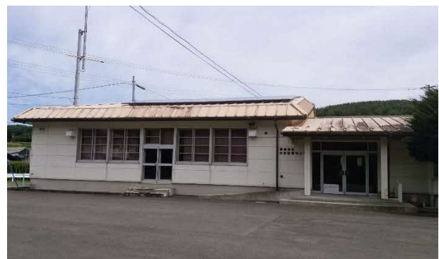
老朽化の進む橋場生活改善センター
