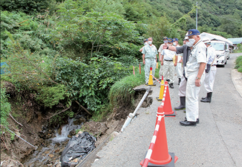
道路の一部が崩落した町道大沢線
