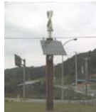
H12 風力・太陽光 ハイブリッド街灯 345W 道の駅ほすなある⑪
