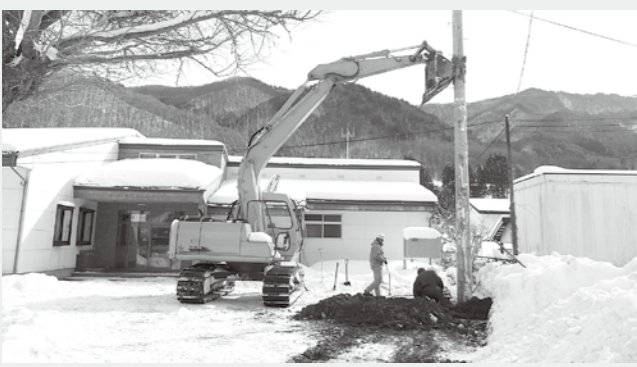
放送用の電柱を設置しています。(1月16日 小田林業研修センター)
